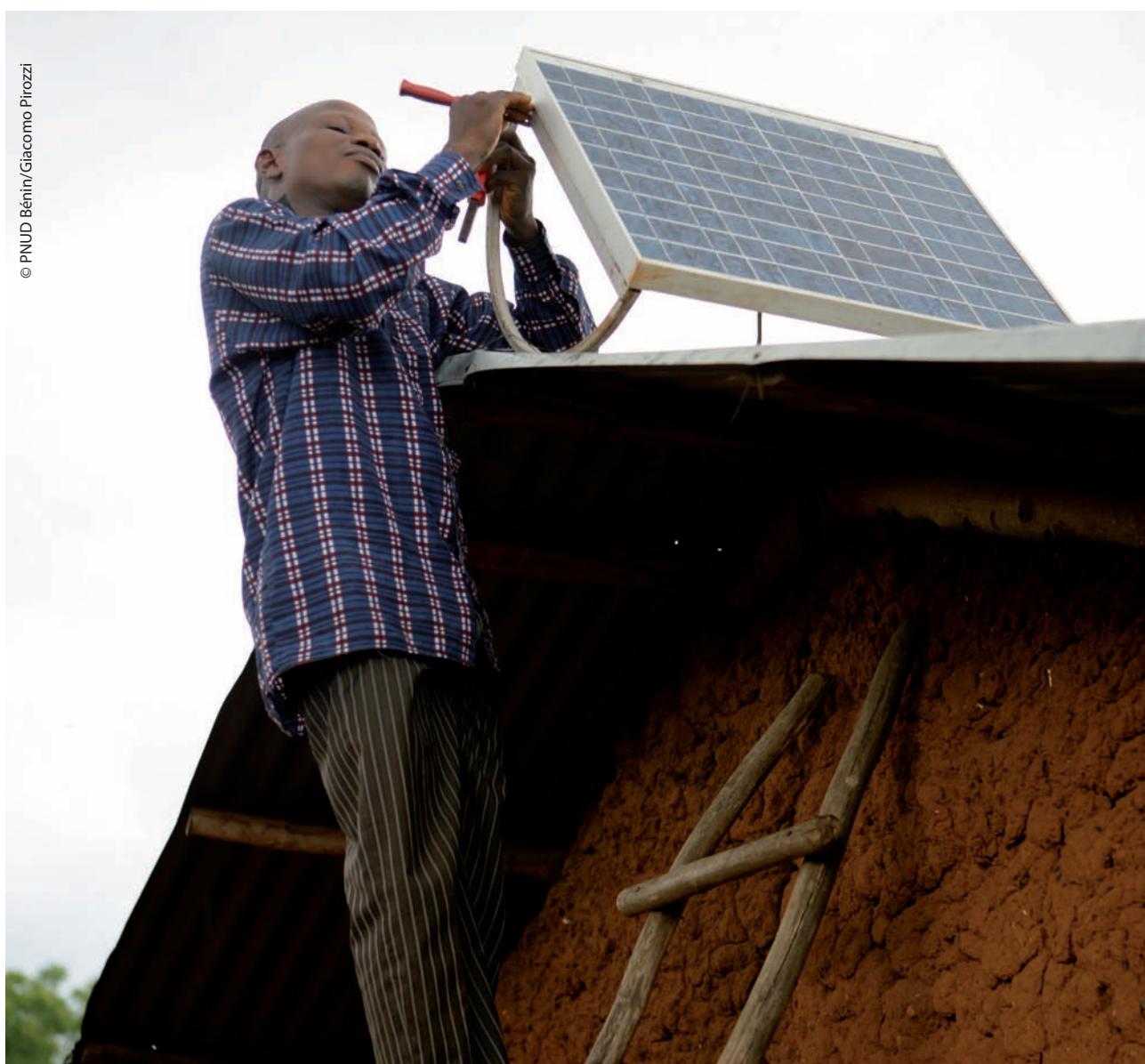
Des panneaux solaires pour alimenter en énergie électrique le village de Hon
